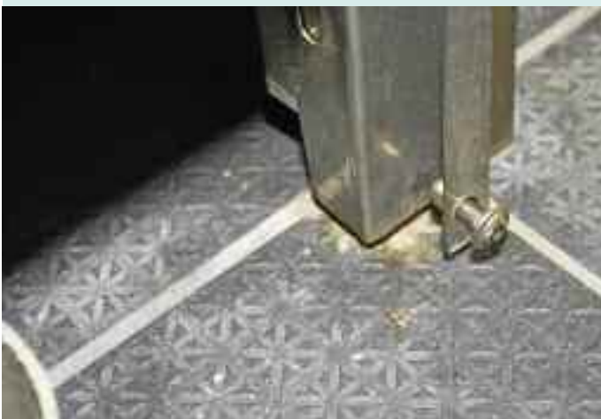
Rostablagerungen auf dem Boden und angrenzenden Edelstahlflächen.
